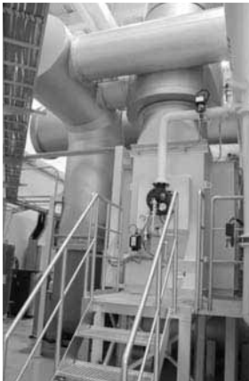
排煙処理設備
