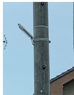
▲町内会で設置された防犯灯(LED灯)
