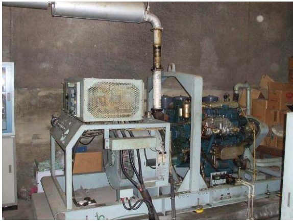
◇自家発電設備（1階自家発電室）
