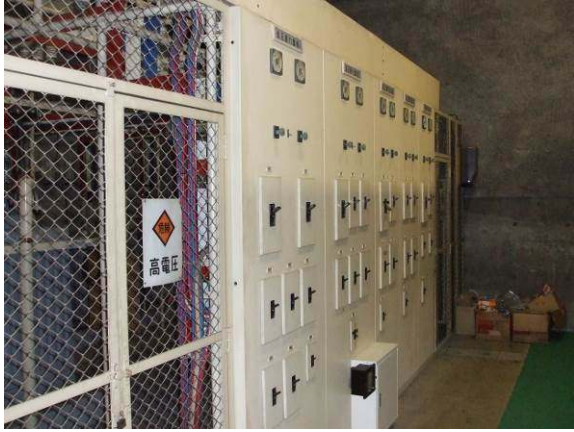
◇受変電設備（1階電気室）
